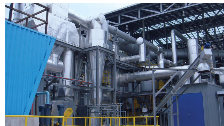
Traitement des boues – ECO (Singapour)
