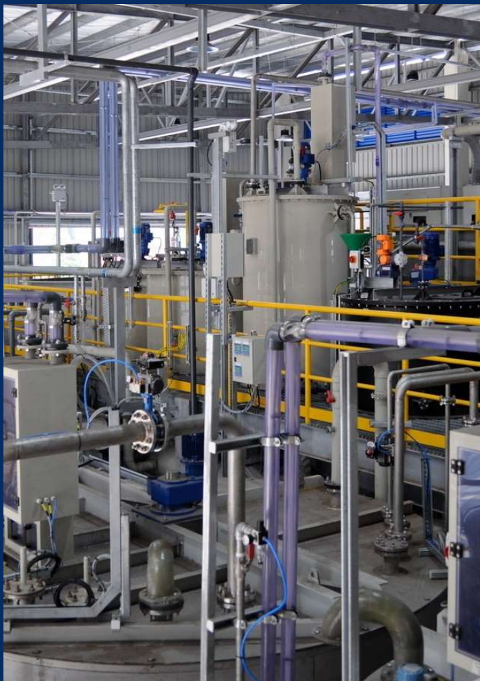
Traitement des boues - ECO (Singapour)
